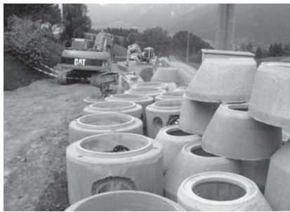
Eben war während der Bauarbeiten nur über einen eigens errichteten Ersatzweg (rechts im Bild) erreichbar. Foto hag
